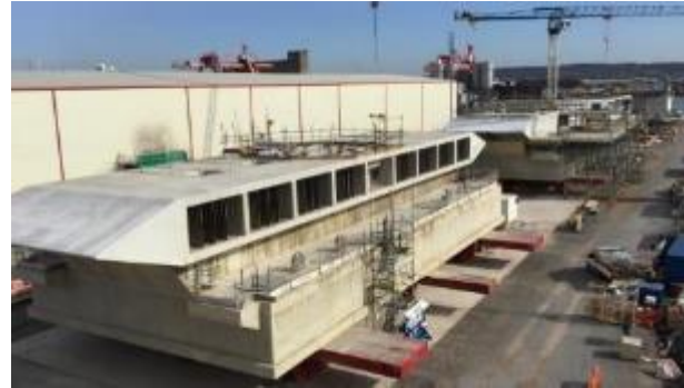
Vue d'une tête de prise d'eau
