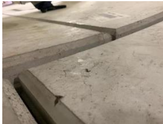
Exemple de décalage entre voussoirs lors de la pose
