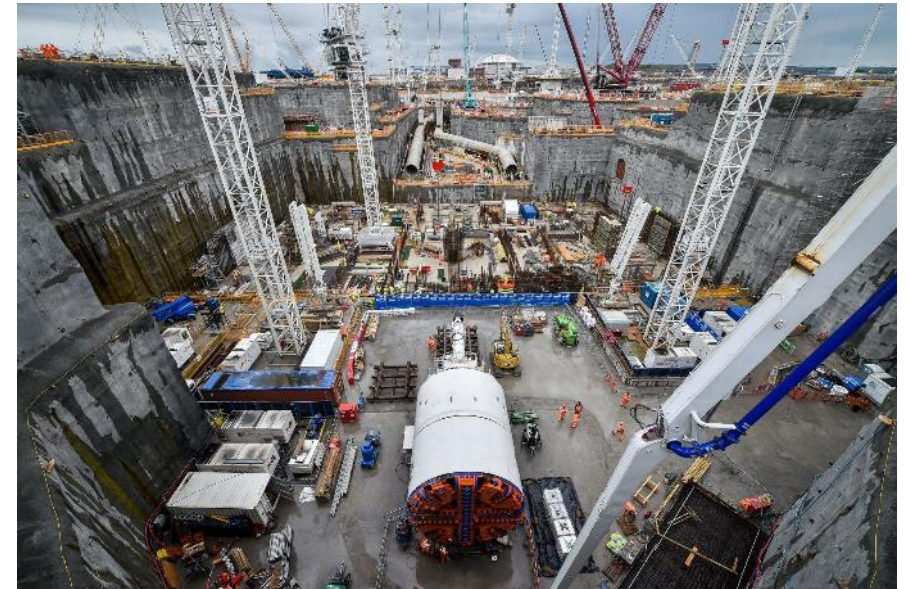
Assemblage du tunnelier dans l'aire de lancement (fouille de la station de pompage)
