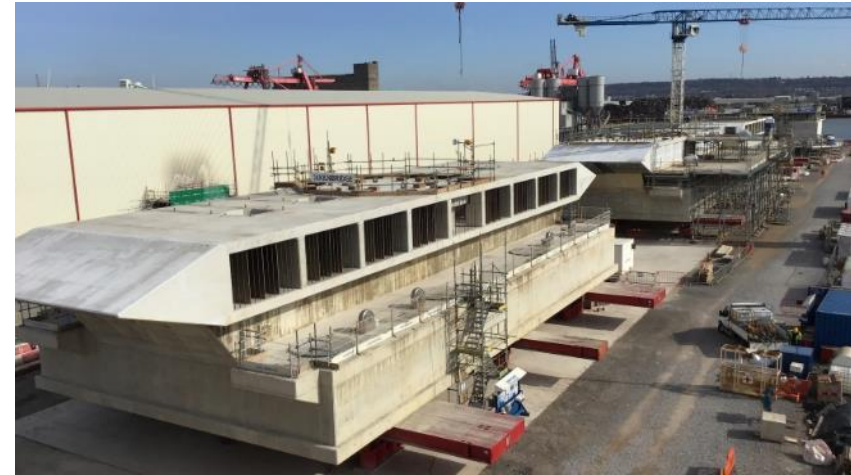
Vue d'une tête de prise d'eau
